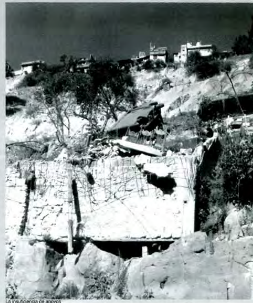
La insuficiencia de apoyos
