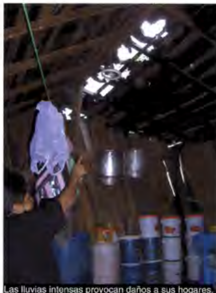
Las lluvias intensas provocan daños a sus hogares.
