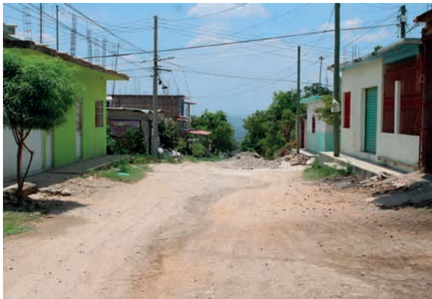
Calle sin pavimentar ubicada en la Colonia Julio César Ruiz Ferro, en Chiapa de Corzo. Las autoridades locales se han negado a pavimentar las calles, con el argumento de que son colonias irregulares, por lo que los habitantes urgen su regularización.
