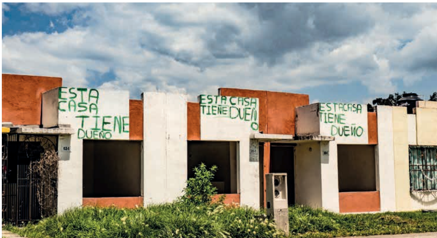
Los compradores de vivienda han sido víctimas también de empresas inmobiliarias, quienes entregaron casas sin los servicios de agua, luz eléctrica, espacios recreativos, entre otros. Hoy reclaman atención mientras las viviendas se derrumban.
