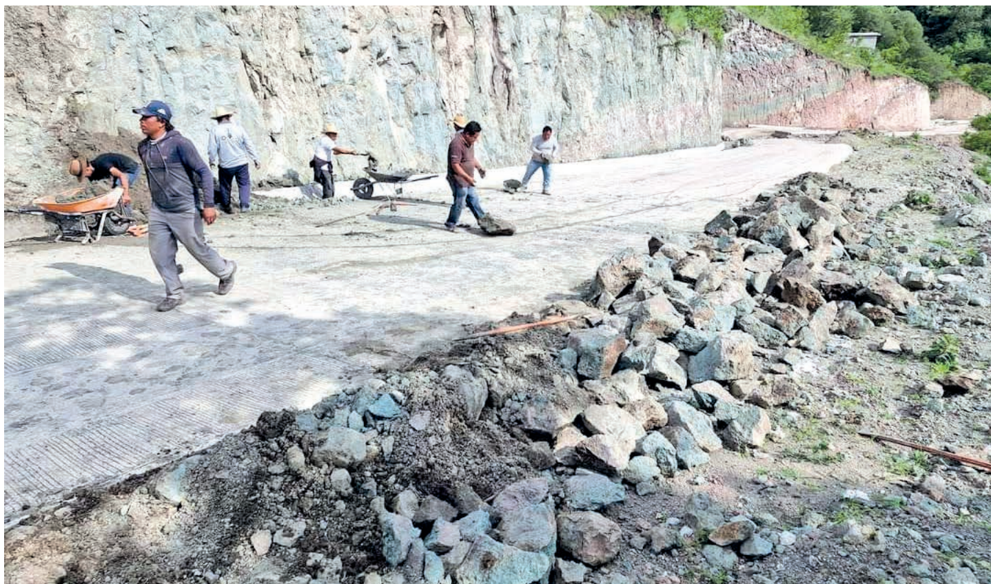
La construcción de siete kilómetros de camino artesanal en vecinas comunidades mixtecas de la ruta San Vicente Amole sigue inconclusa y su mal estado pone en riesgo la vida de quienes transitan por ahí.
