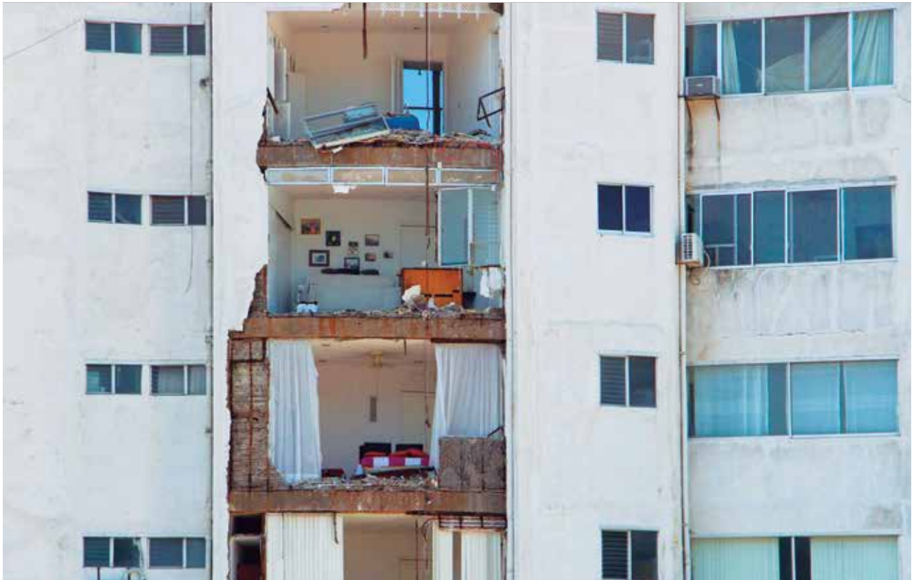
Al terremoto de 7.1 grados se sumaron más de mil réplicas, algunas de mediana intensidad, según el SSN, que han provocado la caída de bardas, deslizamiento de tierra, piedras y abierto grietas en los edificios de diferentes partes del municipio, además de tres fallecidos.
