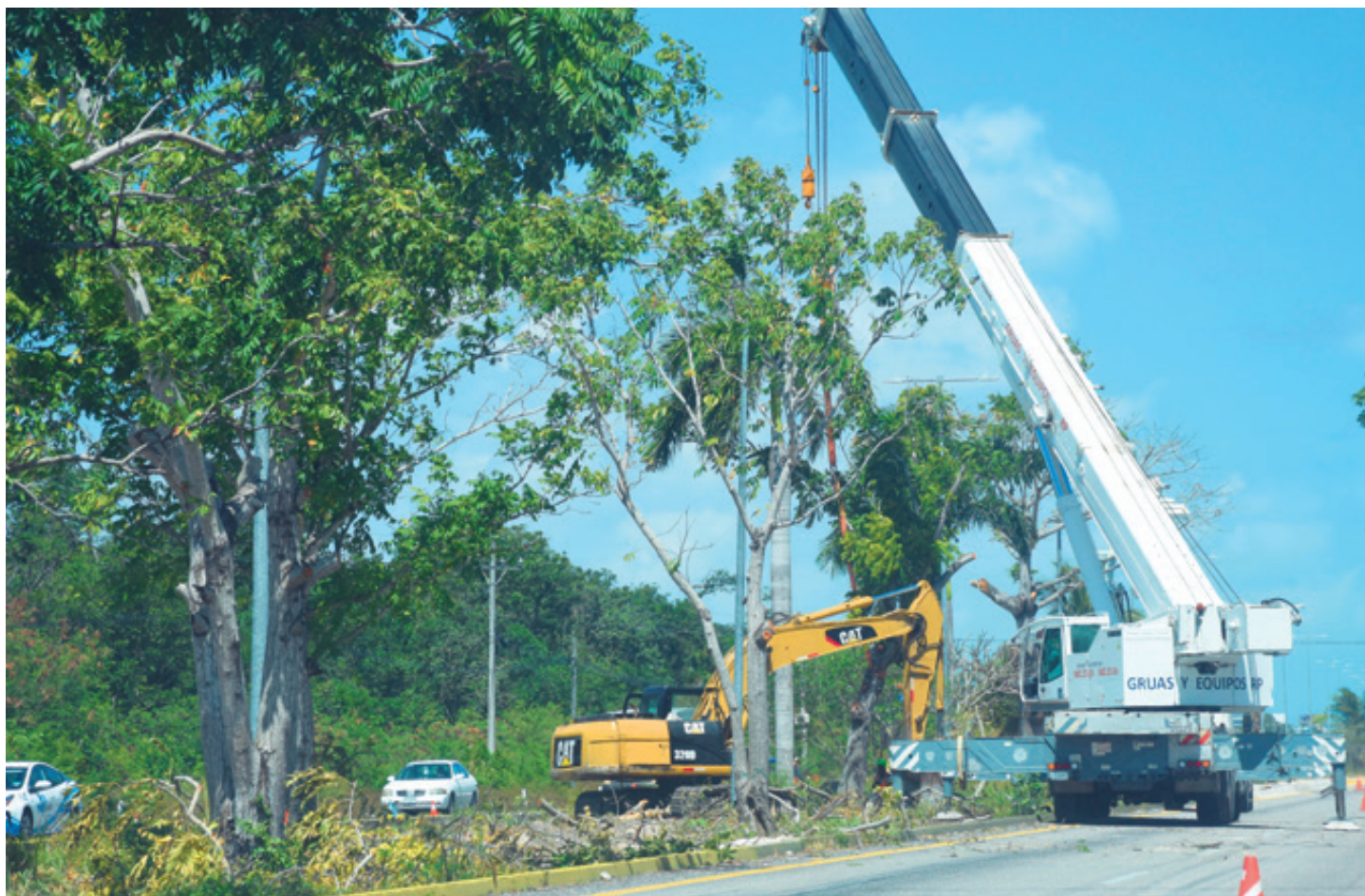
Aspectos de los trabajos de reubicación de entre 500 y dos mil árboles nativos del camellón central de la Carretera Federal 307 por el paso del Tren Maya. Largas filas de automóviles se pueden observar por los trabajos que ya dieron inicio.
