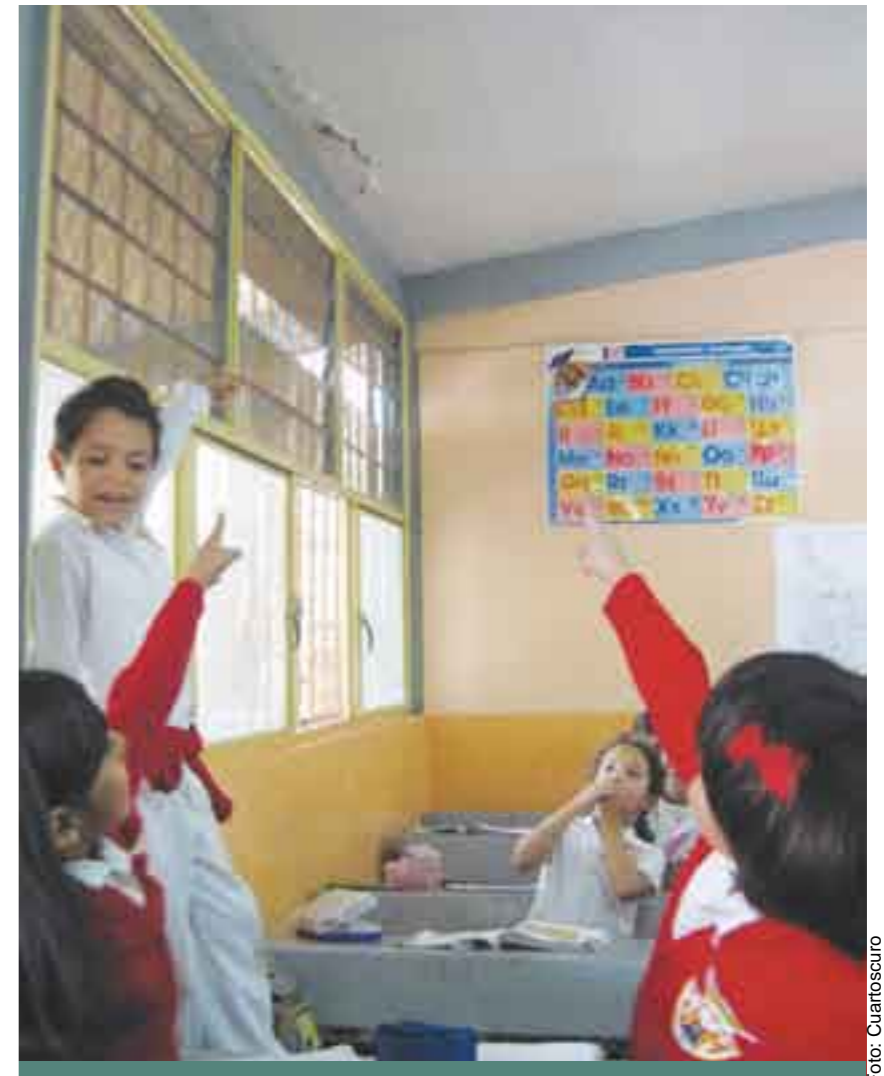
Guerrero. Infraestructura muy vulnerable ante fuertes sismos.
