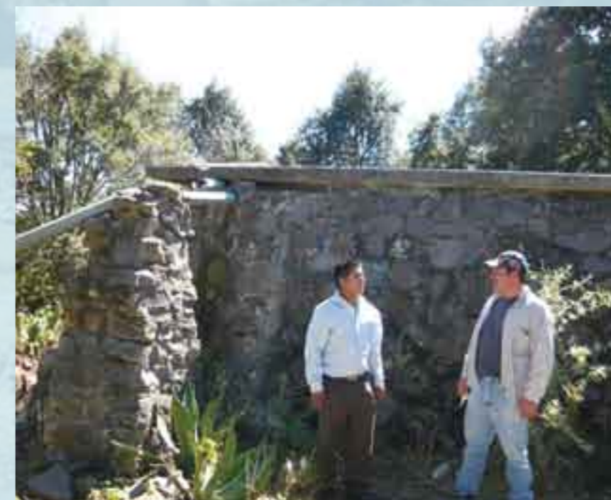
Uriel Bernal y Mauricio Martínez junto al pozo dañado.
