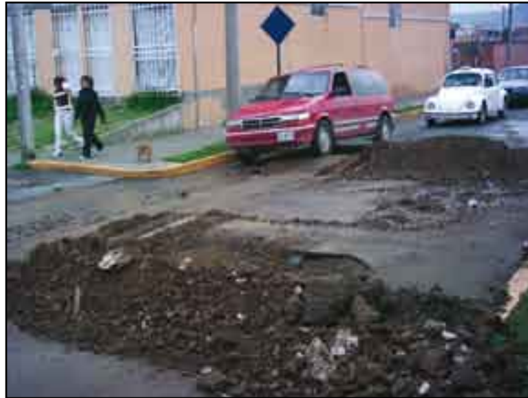
Unidades habitacionales. En malas condiciones.
