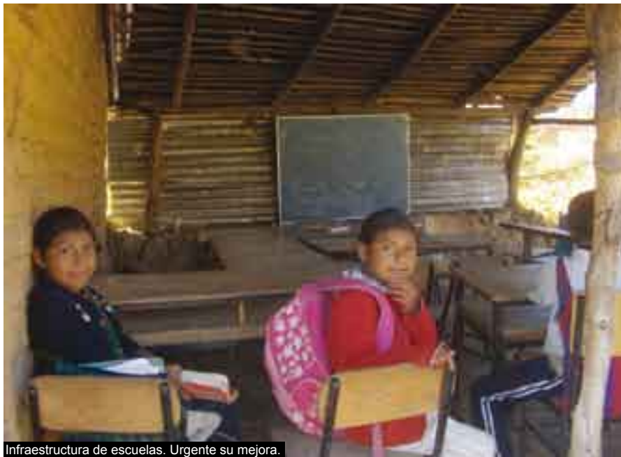
Infraestructura de escuelas. Urgente su mejora.
