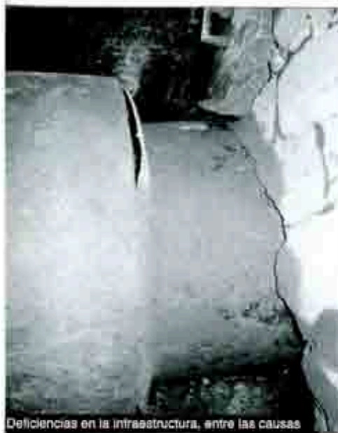
Deficiencias en la infraestructura, entre las causas
