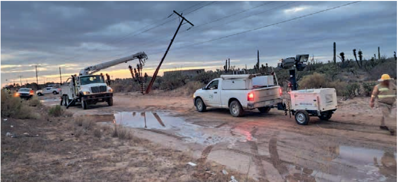
En Baja California Sur, 89 mil 918 usuarios de la CFE se quedaron sin electricidad durante un par de días.
