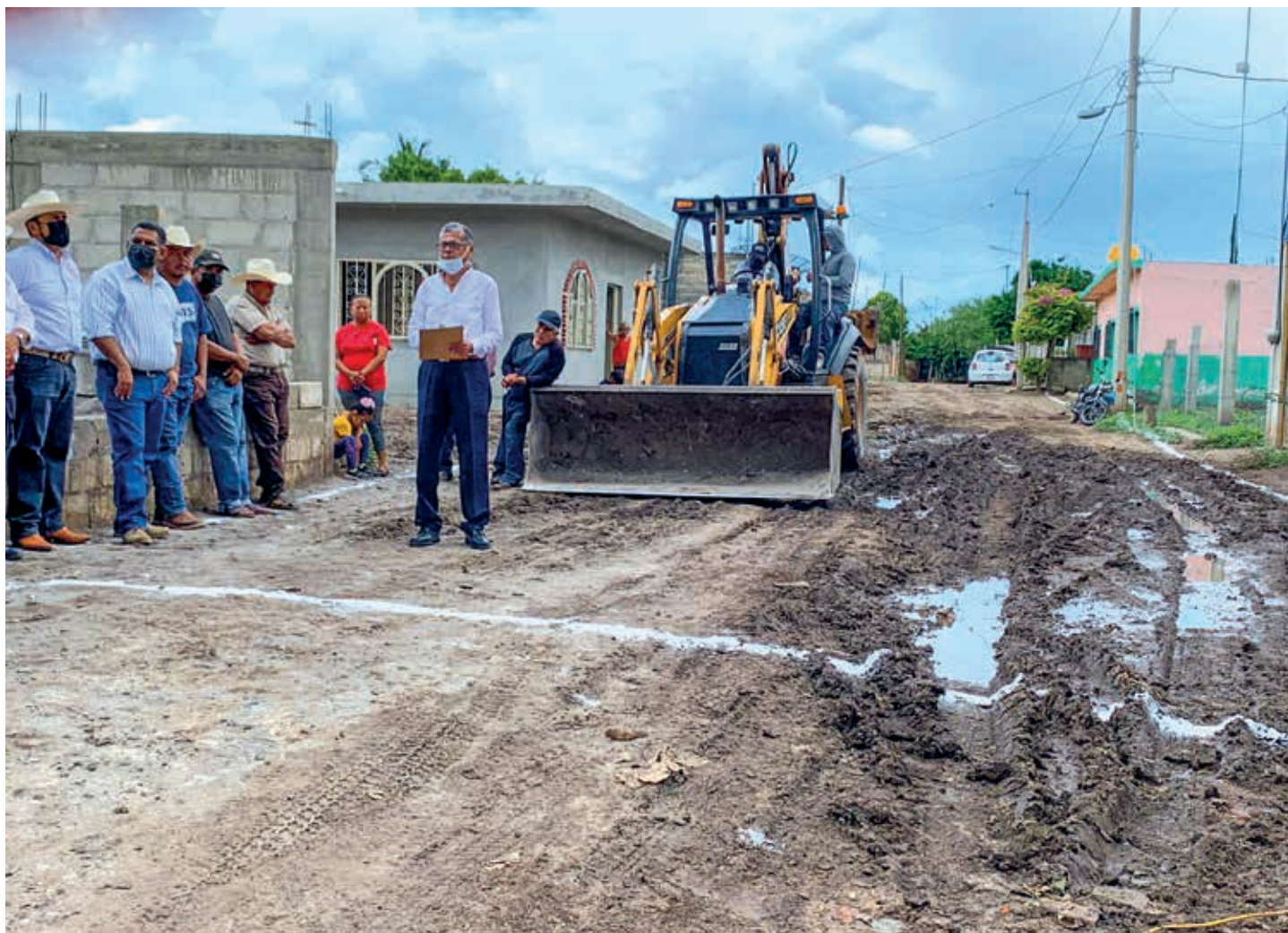
Los pobladores de San Nicolás Tenexcalco, Chietla, pidieron a los diputados de todas las bancadas que aumentaran el presupuesto en este rubro, porque las calles de su localidad se encuentran en mal estado.
