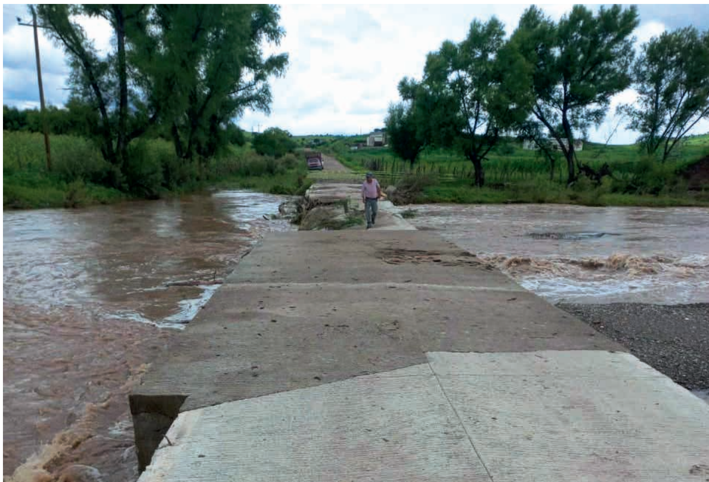
En el municipio de Rodeo colapsaron dos puentes, se reportaron tres escuelas con daños, dos transformadores quemados, pozos de agua ensolvados, daños en la iglesia, caída de tres bardas y caminos rurales dañados, así como algunos techos de viviendas caídos.
