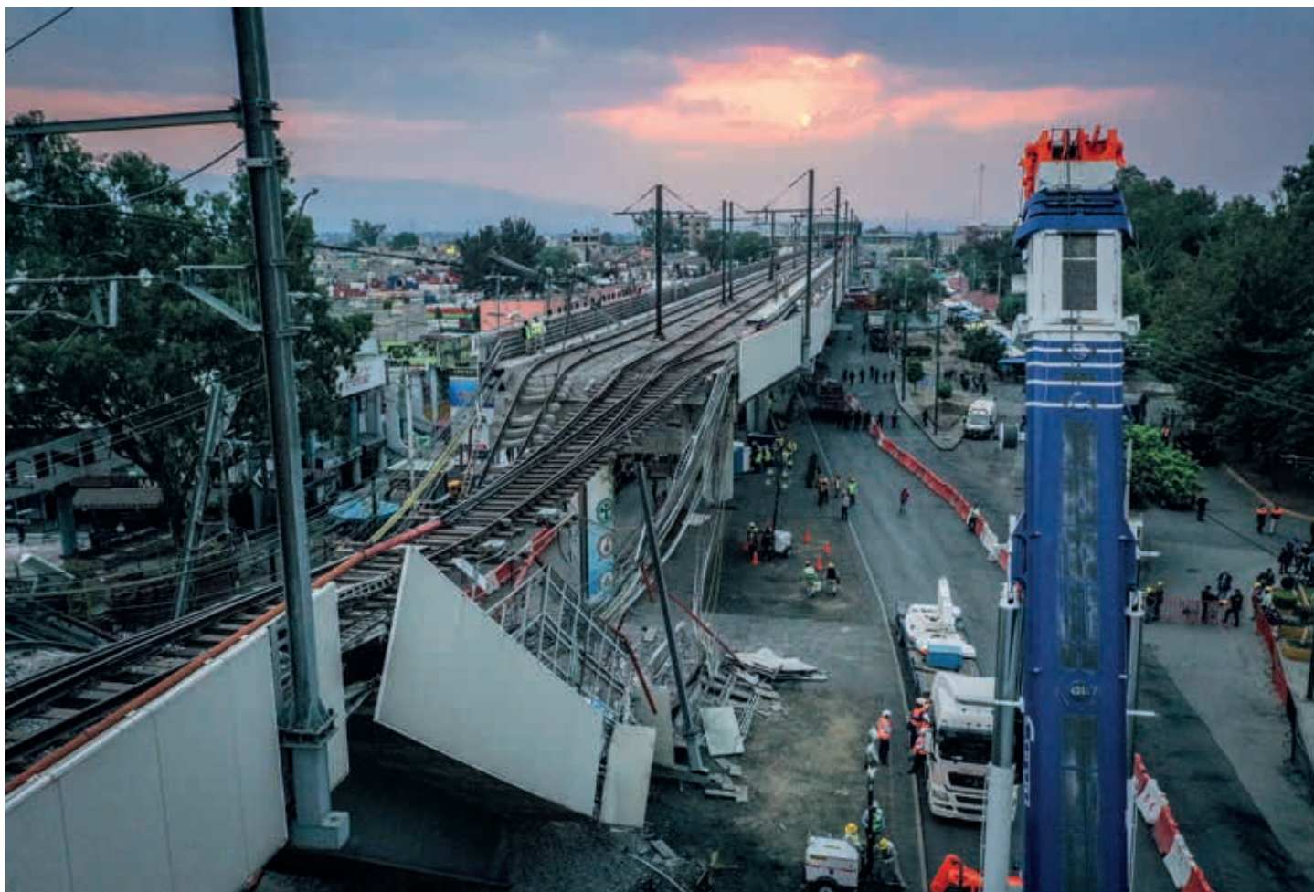
A Florencia Serranía, responsable también por la falta de mantenimiento que ocasionó el derrumbe de la Línea 12, ahora se le premia colocándola en el Consejo Nacional de Ciencia y Tecnología (Conacyt), en lugar de procesarla por las muertes causadas por el accidente.
