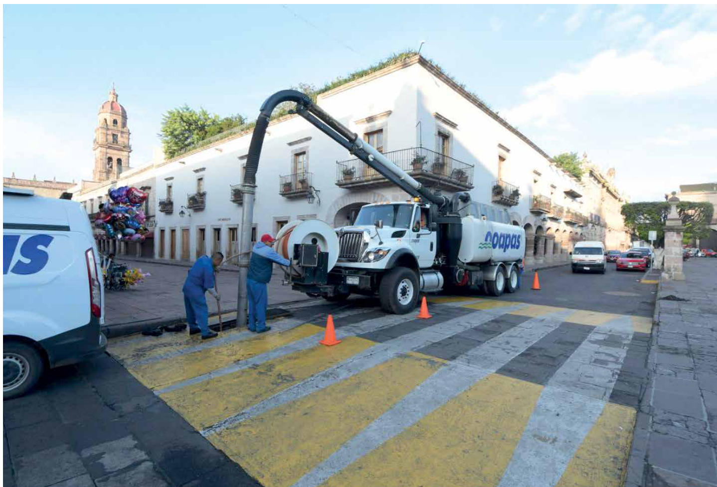
La causa principal de los encharcamientos radica en que las coladeras instaladas en 2017 son más angostas y tienen menor capacidad para desahogar el agua de lluvia.
